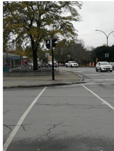
Figure 4: Intersection désalignée avec la dénivellation du bateau-pavé (Atwater/Duvernay)
